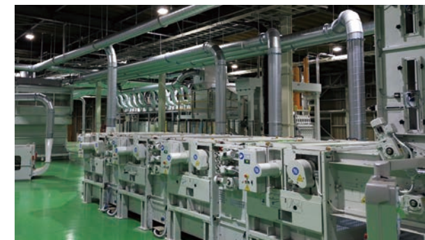
古着反毛リサイクル設備
